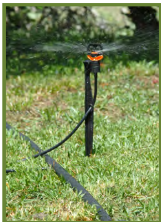
INSTALACIÓN ROTOR RAIN PLUS EN FRUTALES
