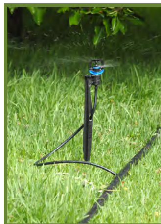
INSTALACIÓN ROTOR RAIN PLUS EN FRUTALES
